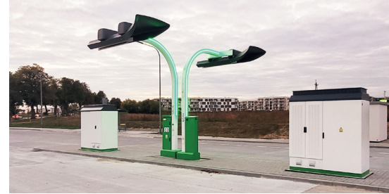
Flea 4 SECC in einer Ladestation installiert
