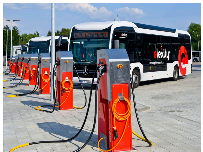
Ladestationen der Verkehrsbetriebe Hamburg-Holstein GmbH nutzen das intelligente Lademanagement MOBILEcharge.
